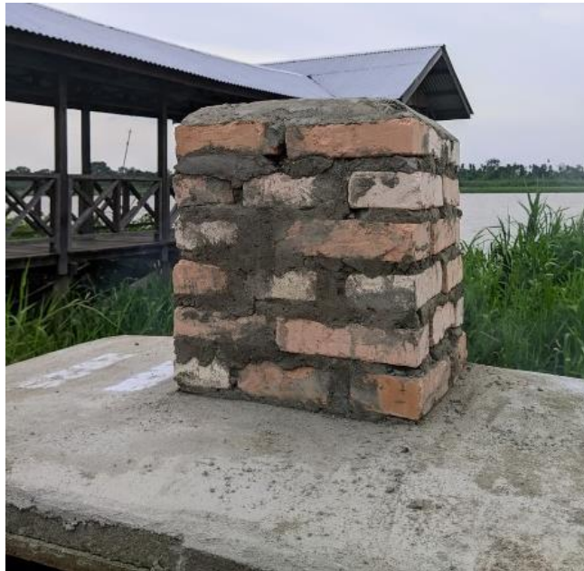
Gambar 3 Cerobong Tempat Pembakaran Sampah
