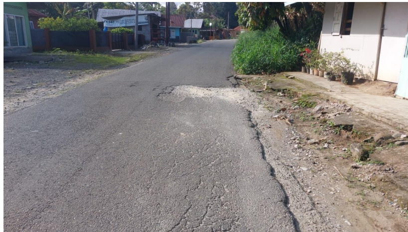
Gambar 5: Kondisi tepi jalan tanpa saluran drainase pada STA 5+400-5+500
