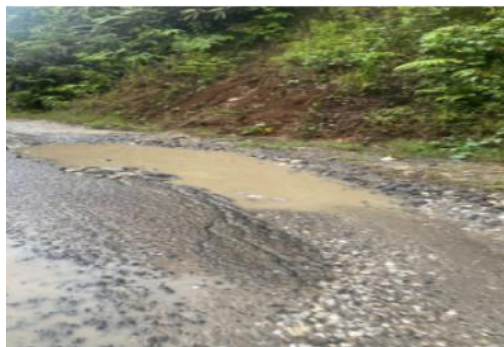
Gambar 2: Kondisi Kerusakan Ruas Jalan Sitingkai
