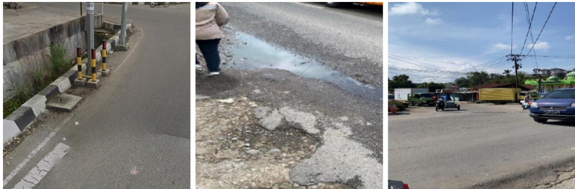
Gambar 3. Kondisi lapangan: (a) STA 0+000, zebra cross pudar dan tanpa bahu jalan; (b) lubang tergenang air pada Segmen 3; (c) simpang STA 1+703 tanpa APILL dan marka Sumber: Dokumentasi lapangan, 2026.
