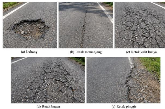
Gambar 2. Jenis Kerusakan Jalan
