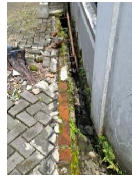
Gambar 3 Kondisi saluran eksisting dengan dinding saluran yang rusak terletak di saluran S55
