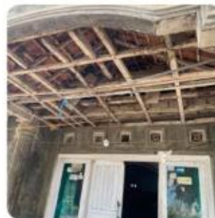
Kondisi atap dan plafond rumah
