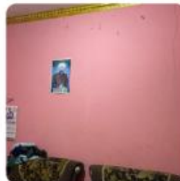
Kondisi dinding rumah
