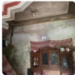
Kondisi dinding dan plafond rumah
