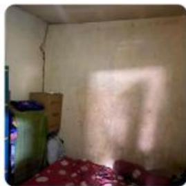
Retakan pada dinding
